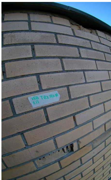
15 спуск, тех. этаж, 2 подъезд
