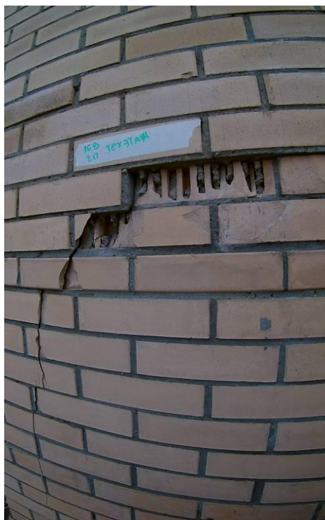
16 спуск, тех. этаж, 2 подъезд
