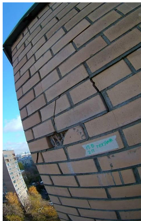
15 спуск, тех. этаж, 2 подъезд
