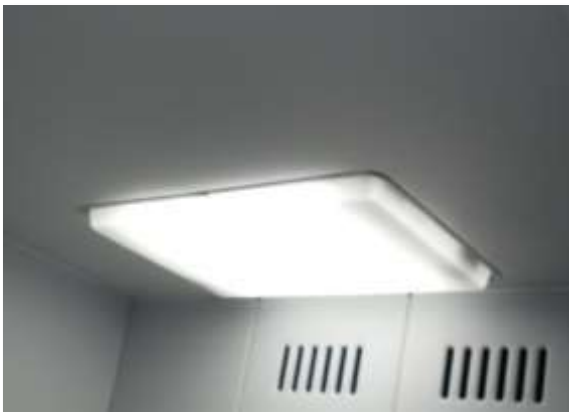
Аварийное освещение кабины лифта
